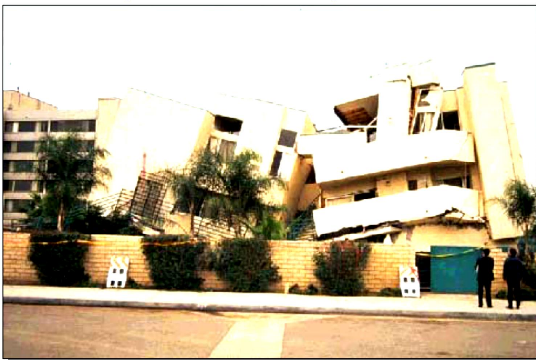
شکل (۱-۱۳): خرابی ساختمان‌ها در اثر تکان‌های شدید زمین
