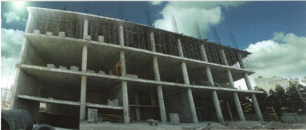
مجتمع تجاری سالاریه محل پروژه: شهر قم بلندترین دهانه: ۱۱ متر ضخامت دال: ۴۰ سانتی متر زیربنا: ۴۵۰۰۰ متر مربع
