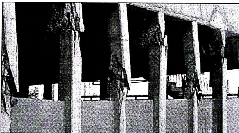
شکل (۹-۱۷): مکانیسم خرابی ستون‌ها به علت عملکرد نامناسب تیر قوی - ستون ضعیف
